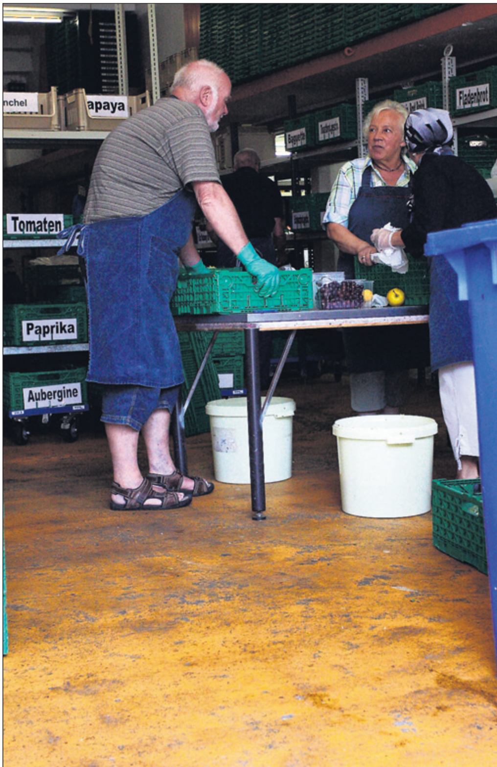
Vorsicht, Rutschgefahr! Der alte Betonfußboden im Haus der Achimer Tafel an der Unterstraße ist mit Schründen übersät und nur schwer sauber zu halten. Fotos: Marquart
