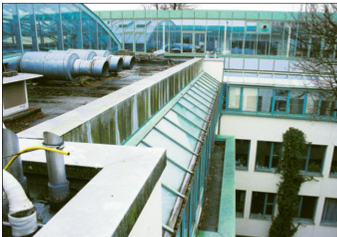
Besonderes, aber schlecht geplantes und gebautes Rathausgebäude. Die „Tropfsteinhöhle“ muss teuer saniert werden.
