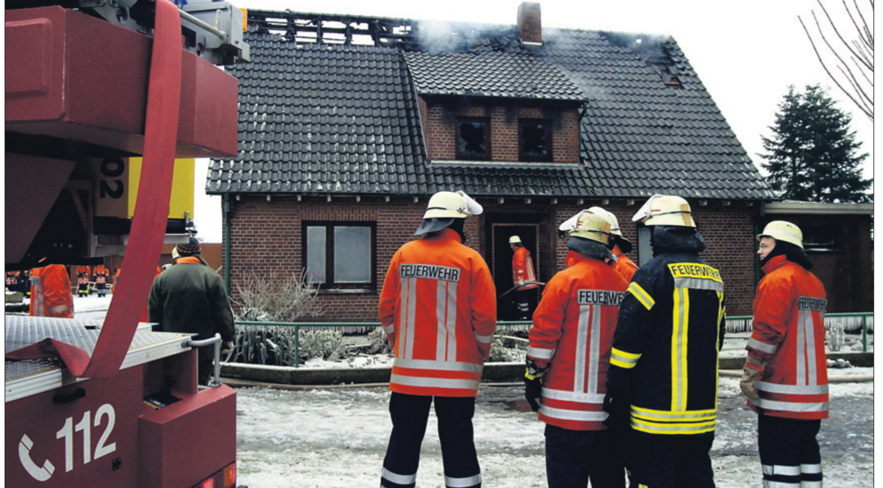
Trotz des Großeinsatzes von fünf Feuerwehren brannte der Dachstuhl des Wohnhauses komplett aus. „Das Gebäude wird unbewohnbar sein, davon müssen wir ausgehen“, so Polizeipressesprecher Jürgen Menzel. Fotos: Albrecht
